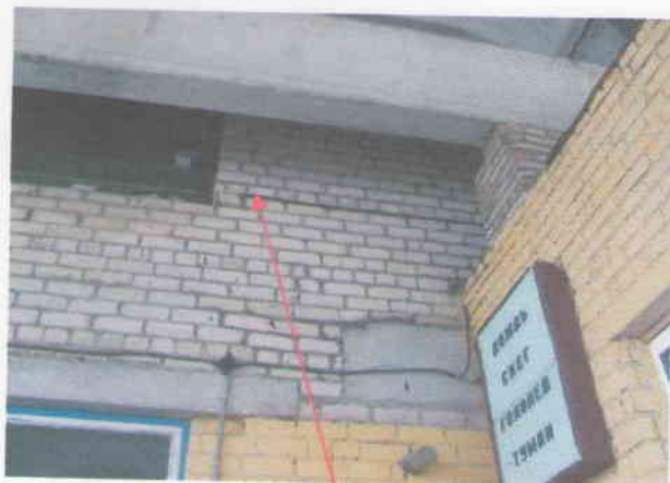
выход кабеля связи из здания №36
