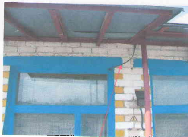
вход кабеля связи в здание АЗС
